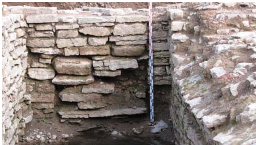
Abb. 10. Die zugemauerte Türöffnung in der Ostwand des Überbleibsel des Gebäudes Große Straße 26. Foto von Aivar Kriiska.
