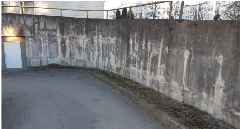
08.12.2020 ITK kiirabiastakaadi korrodeerunud armatuuriga tugisein. Esialgne soov seda ehitusel ära kasutada ei tulnud peale uuringuid kõne alla. Lammutstööd suurendasid ümberehituse maksumust.
