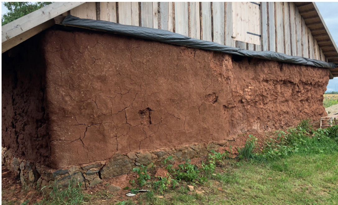
Foto 3. Hoone põhjaseinas tehtud ebaõnnestunud parandus. Täitesegus on liiga vähe põhku ja olemasoleva aluspinna puhastamisega pole ülearu vaeva nähtud. Malvo Tominga foto.
