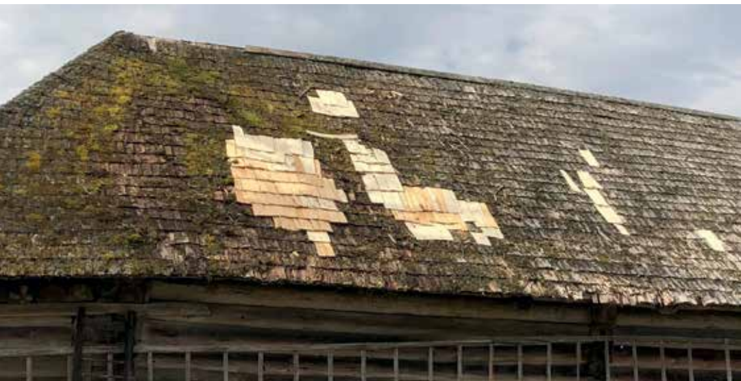
Foto 9. Katuse kõrval kasvanud suure vahtra varjus on katus kahjustunud ja sammaldunud märksa enam kui teisel katusepoolel. Mesipuu talu ait. Foto Mikk Tagapere, 2024.
