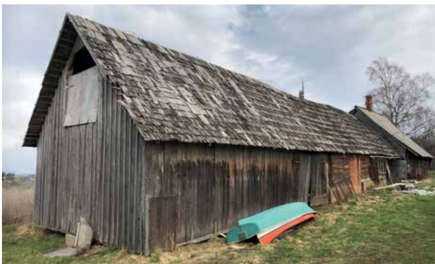
Foto 4. Okaspuulaast katuse lõunaküljel. Näha on rohked parandused. Mesipuu talu laut-heinaküün. Foto Mikk Tagapere, 2024.
