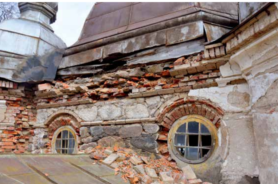
Foto 8. Lalsi kirik. Tambuuritorni lõunaküljel olid telliskarniisid katusekatte puudumise tõttu varisenud. Foto Andres Uus.
