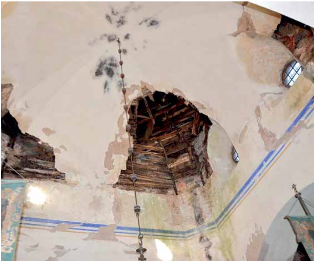
Foto 7. Lalsi kirik. Tambuuritorni ja nurgatornide liitekohtades oli katuseplekk kõigis neljas nurgas hävinud, katusekonstruktsioon läbisajust määrdunud ja laed kohati sisse varisenud.
