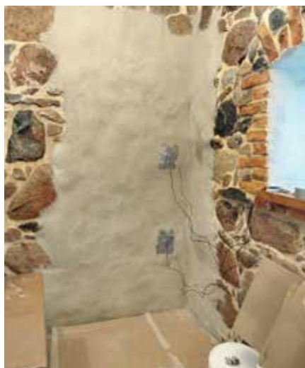
Foto 21. Termokrohvi kaetud sisesein temperatuurianduritega, 11.11.2024. Kahe täiendava anduri abil saab jälgida välis- ja üldist sisetemperatuuri. Mõõtmistööd teostab hoonete biokahjustuste spetsialist Kalle Pilt, kes analüüsib termokrohvi efektiivsust soojusjuhtivuse ja hoone sisekliima parandamisel. Esimesed tulemused on üles märgitud 2025. aasta kevad-suvel. Andurid jäävad seina ka 2025–2026 aasta talveperioodiks. Foto Tiina Angerjäär.
