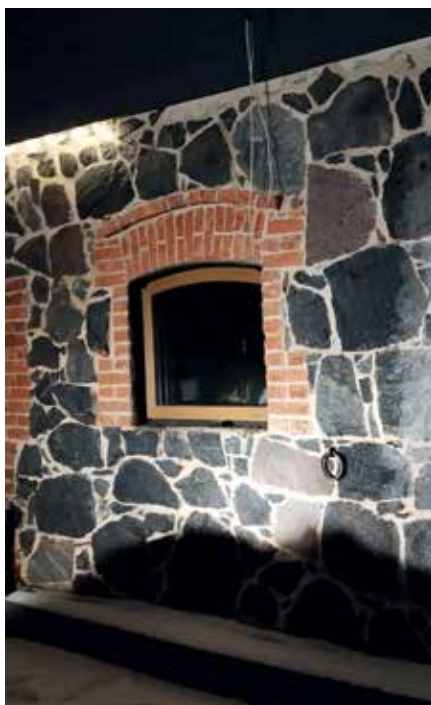
Foto 20. Välisseina külmasillad sulailmaga, 09.01.2024. Foto Tiina Angerjäär.
