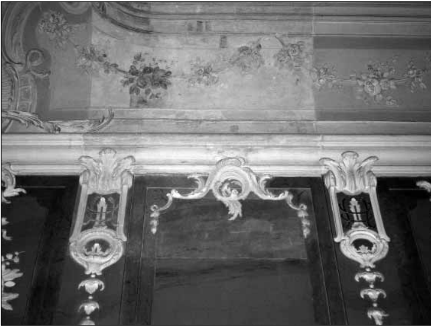
Abb. 6. Wandfragment im Saal des Schlosses Schönhausen während der Restaurierungsarbeiten. Foto von Imants Lancmanis, 2007.
