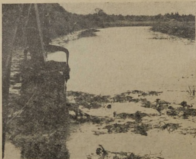
Joon. 20. Ühenduskanali kaevamisega on välja jõutud suurde Kullasaare kooldu 29. 08. 59. Koolu kaldal on paljusid vanajõgesid iseloomustav pajustikuriba.
